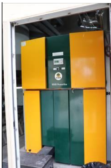
Figura 23 Caldera de biomassa
