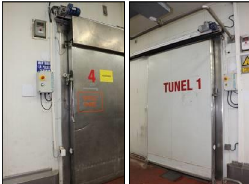
Figura 25 Automatització de càmeres frigorífiques
